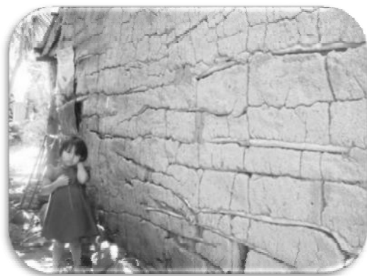
Vivienda de bahareque en condiciones precarias en el Cantón El Pinalito, Santa Ana (Hábitat idóneo para la chinche picuda)
